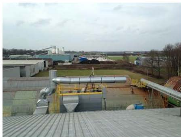
Emissiebron E04 (stoffilter halafzuiging).
