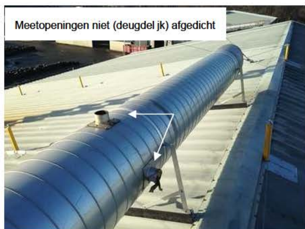
Emissiebron E02 vermaling Eldan; meetopeningen niet (deugdelijk) afgedicht
