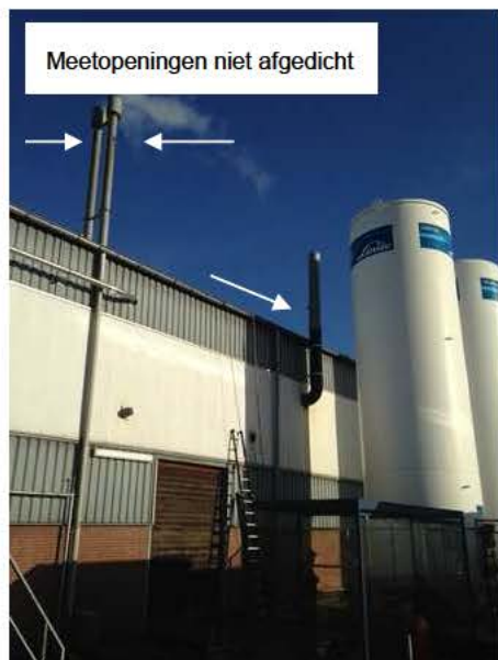
Diverse emissiebronnen (o.a. E01-A en E01-B); meetopeningen niet afgedicht
