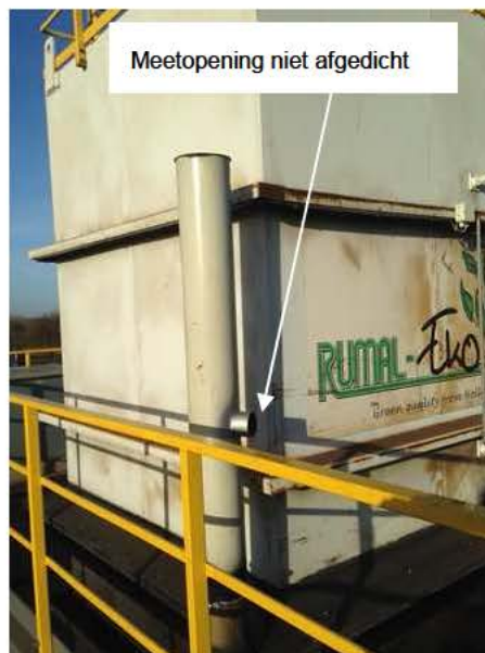
Emissiebron E03; meetopening niet afgedicht
