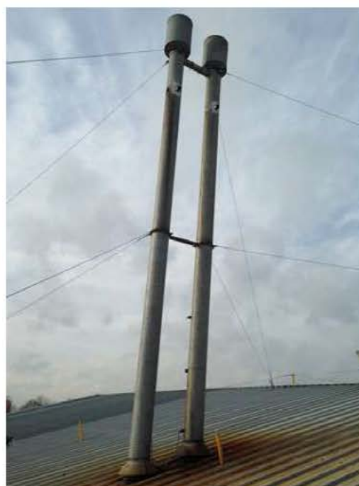
Emissiebronnen E01-A en E01-B (bovendaks).
